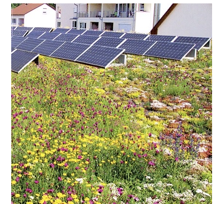
Dachbegrünung mit PV kombiniert
